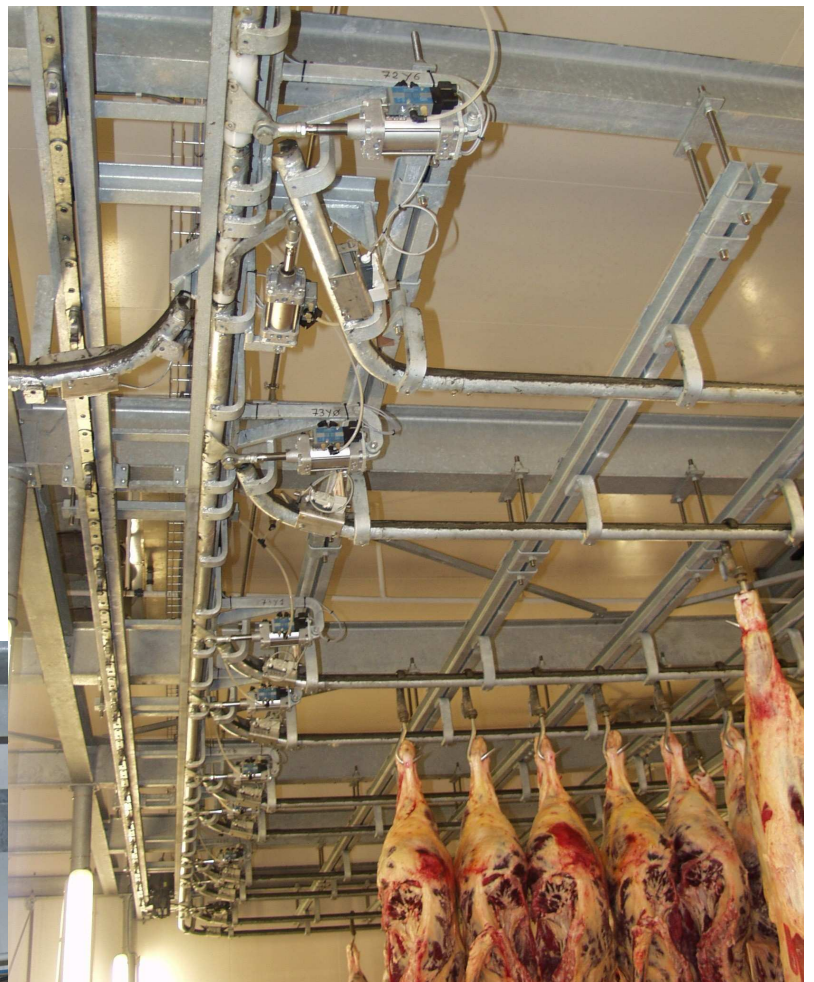
Convoyeur d'amenée sur rails de stockage manuel
